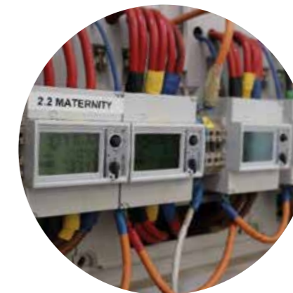
Quell'intricato e colorato sistema di cavi collega i vari meter che permettono di monitorare i consumi energetici dell'ospedale.
